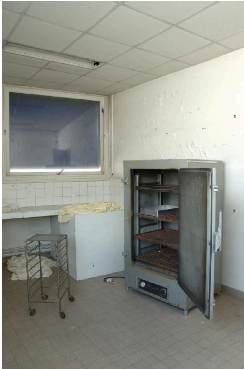
Armoire de stérilisation.
