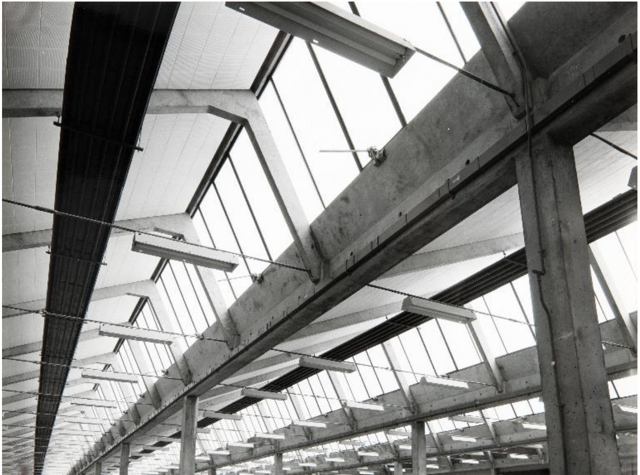
Couverture en sheds des ateliers, vers la fin des années soixante. (Archives municipales de Blois, 13 Z 21).
